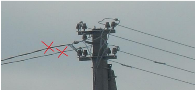
73 pav. Elektros įvado laidų kirpimo vietos
